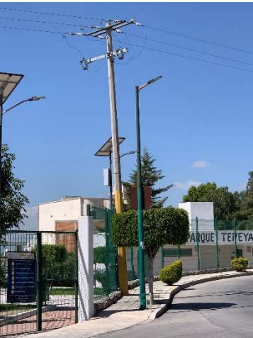
Imagen 4.2.3 Poste de luz en buenas condiciones. Fotografía Propia
