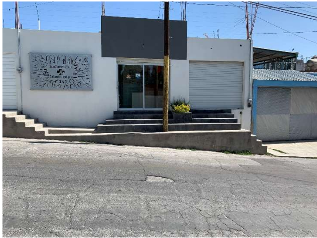
Imagen 4.4.5 Calle 4 Pte. Pendientes erróneas, Fotografía Propia
