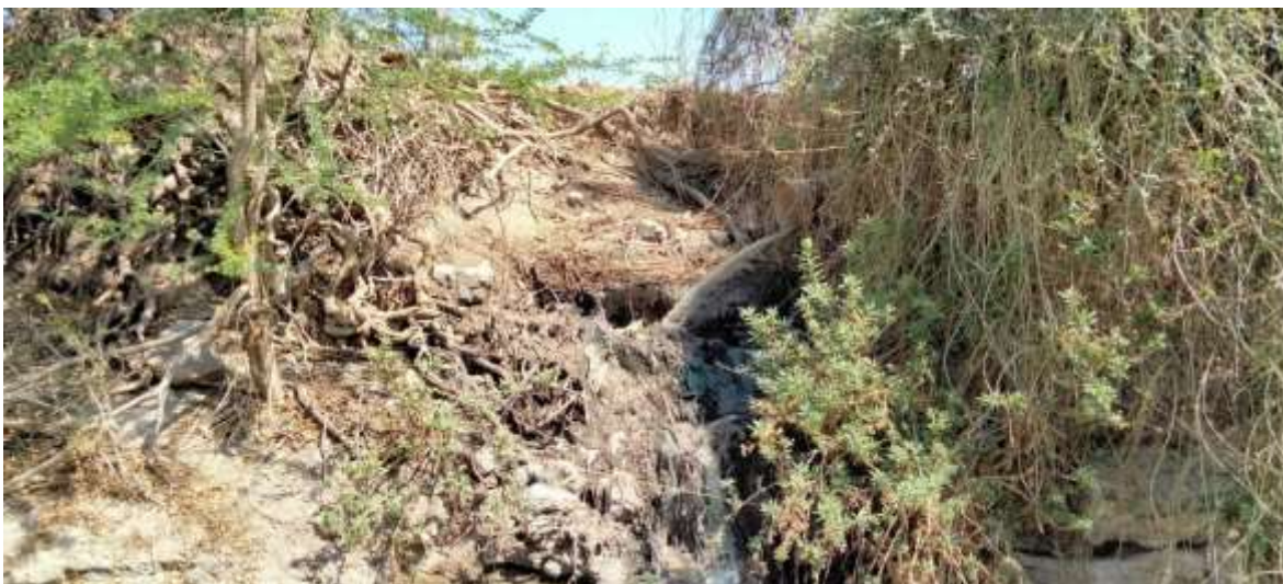
Figura 5 Descarga de aguas residuales debido a una tubería rota. Fuente: Autoría propia.
