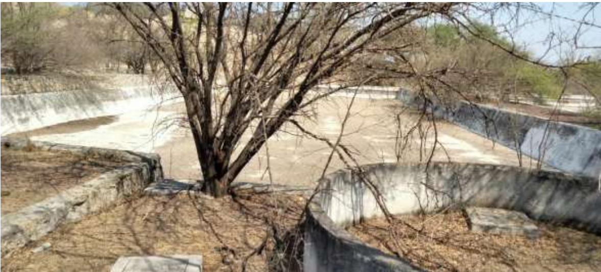
Figura 4 Estado actual de la planta de tratamiento del municipio de Tehuiztzingo. Fuente: Autoría propia.
