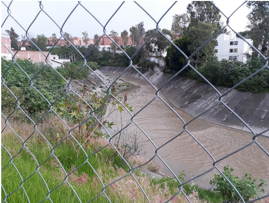
Imagen 12. Tramo revestido de concreto del río Alseseca a la altura del Sector Hacienda-Margarita.
