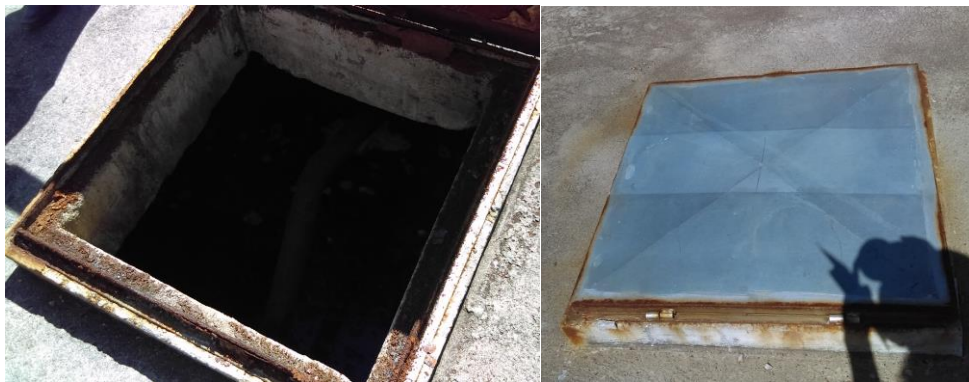
Figura 27. Evidencia de corrosión en reactor anaeróbico provocada por los gases en la PTAR de San Simón Atzitzintla. (Elaboración propia, 2017)
