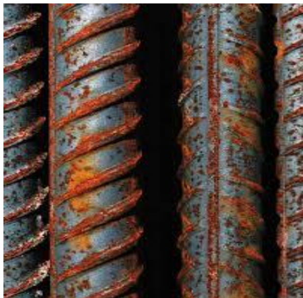
Figura 2.6. Efecto de corrosión en varilla de acero
