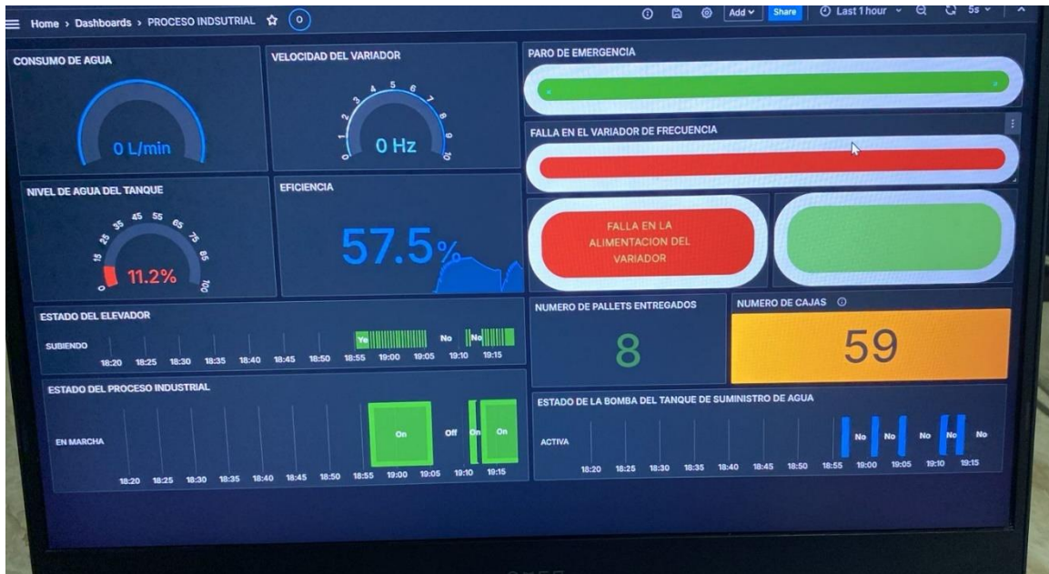
Figura 4.12. Alerta de falla de alimentación del variador en Grafana.
