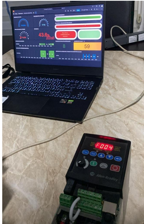
Figura 4.11. Falla en la alimentación del variador de frecuencia.
