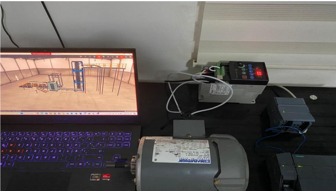
Figura 3.9. Variador de frecuencia PowerFlex4 dentro del subproceso del elevador.
