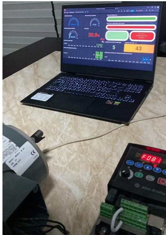
Figura 4.13. Falla en la comunicación Modbus RTU del variador de frecuencia.
