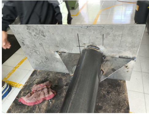
Figura 3.61: Placa unida a la torre.
