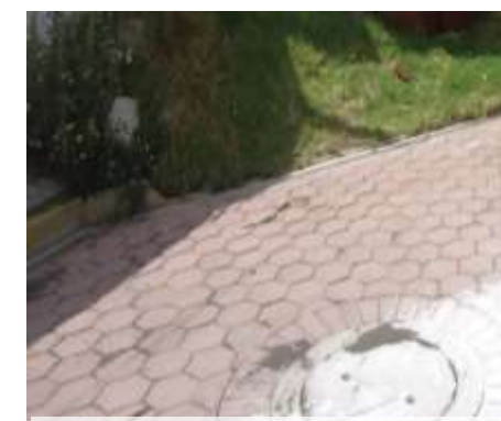
Captura Propia. Calle Francisco I. Madero con red de drenaje.
