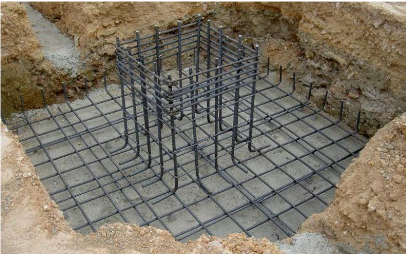
Armado de la zapata, (dado amarrado a la parrilla sobre plantilla de concreto pobre)
