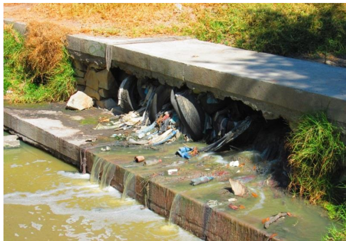
Figura 2.- Barranca El Conde con residuos sólidos y aguas residuales domésticas e industriales. Fuente propia.
