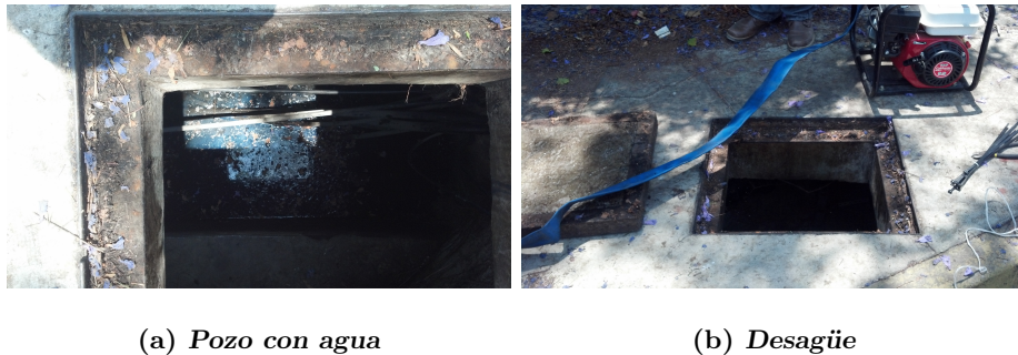
Figura 5.9: Pozo con agua.
