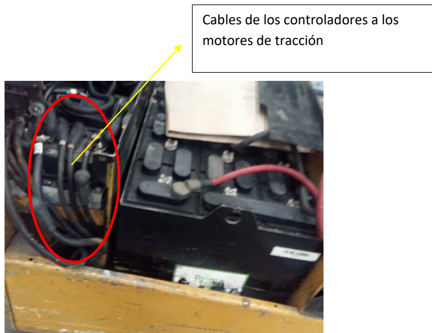
Figura 40 - Cables de conexión
