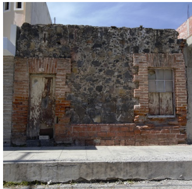
Deterioro en fachada.
