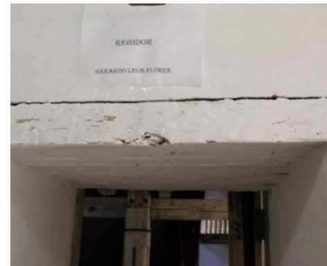
Figura 115: Fisura dintel platea Fuente: Puruncajas Stephanie, 2021
