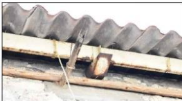
Imagen 2: Oxidación en viga metálica cubierta teatro Fuente: Puruncajas Stephanie, 2021
