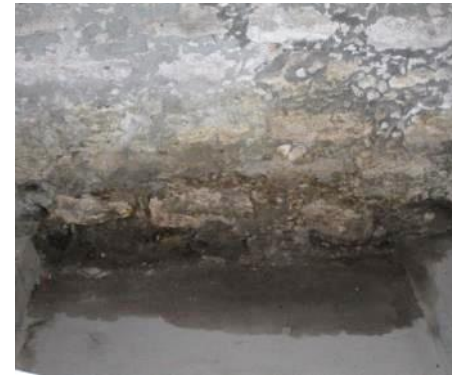
Figura 111: Humedad por capilaridad Fuente: Puruncajas Stephanie, 2021
