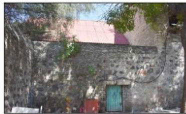
Imagen 1: Vegetación parásita en muro exterior bodega Fuente: Puruncajas Stephanie, 2021
