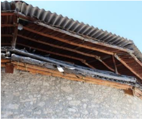
Figura 4: Daños en cubierta corral de comedias Fuente: Puruncajas Stephanie, 2020
