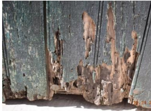
Figura 118: Degradación puerta de madera Fuente: Archivo MACPE, 2020
