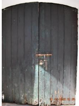
Figura 117: Carcoma en puerta de acceso Fuente: Archivo MACPE, 2020
