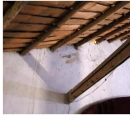
Figura 5: Humedad en muro de piñón Fuente: Puruncajas Stephanie, 2020
