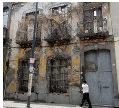
Figura 20: Patrimonio en mal estado de conservación Fuente: Archivo MACPE
