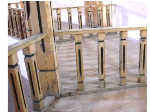
Figura 116: Grieta en pilar de madera Fuente: Puruncajas Stephanie, 2021
