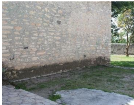
Figura 7: Humedad en la base del muro Fuente: Puruncajas Stephanie, 2020
