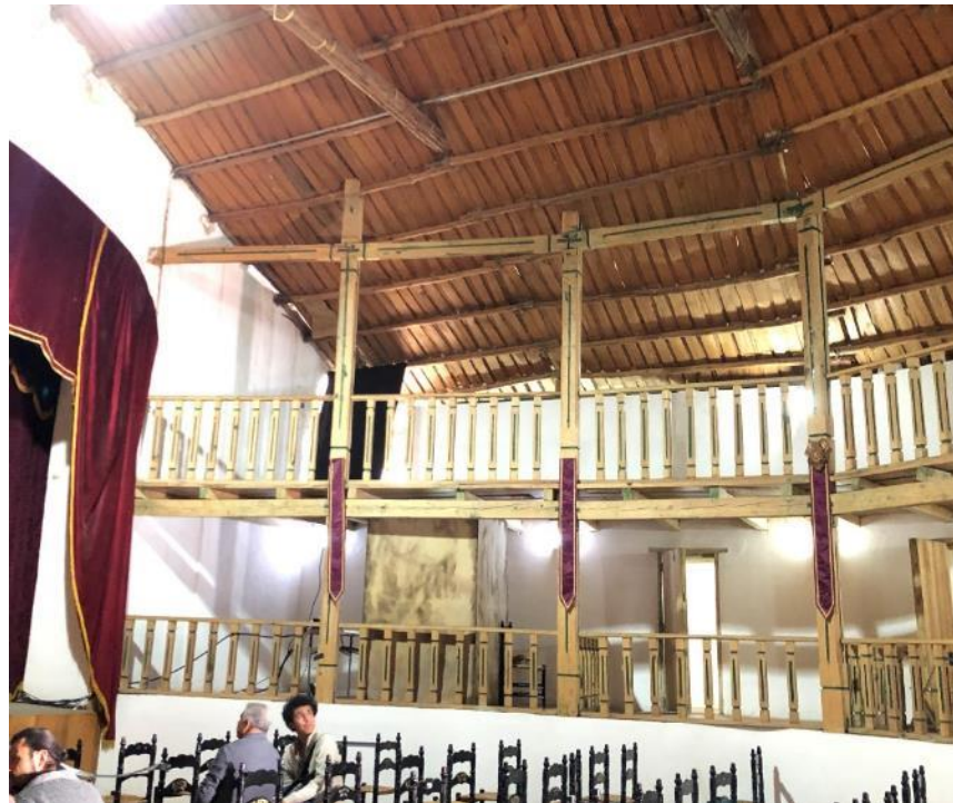
Figura 91: Trabajo en madera de pino en pilares, barandales y cubierta Fuente: Puruncajas Stephanie, 2021
