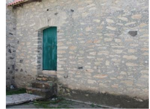
Figura 112: Humedad por capilaridad Fuente: Puruncajas Stephanie, 2021
