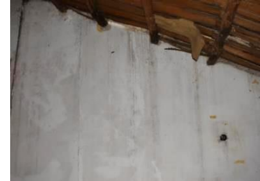
Figura 114: Mancha por escurrimiento en muro Fuente: Puruncajas Stephanie, 2021
