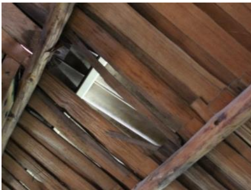
Figura 6: Daños en estructura de cubierta Fuente: Puruncajas Stephanie, 2020
