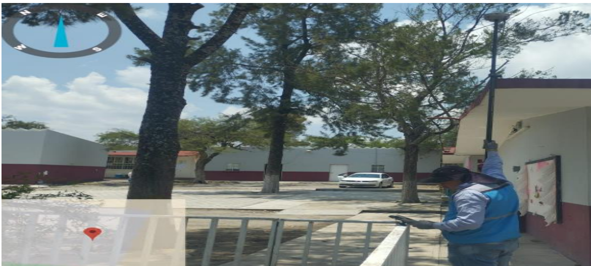
Imagen 44. Usuario y antena receptora en modo rover delimitando la superficie construida de predio en este caso losa de un nivel.
