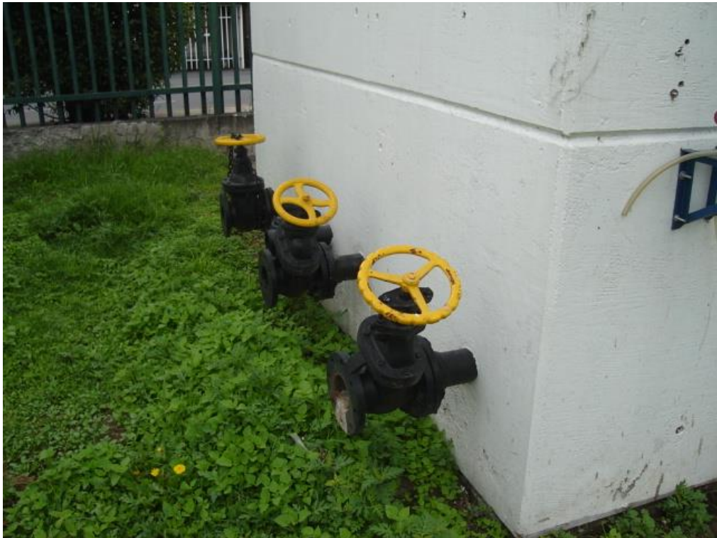
Foto de Reactor Anaeróbico y salidas de lodos.
