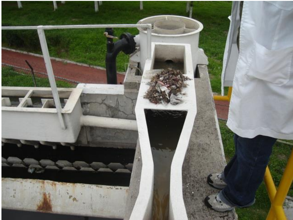
Foto de Canal Parshall o Canal de Medición.
