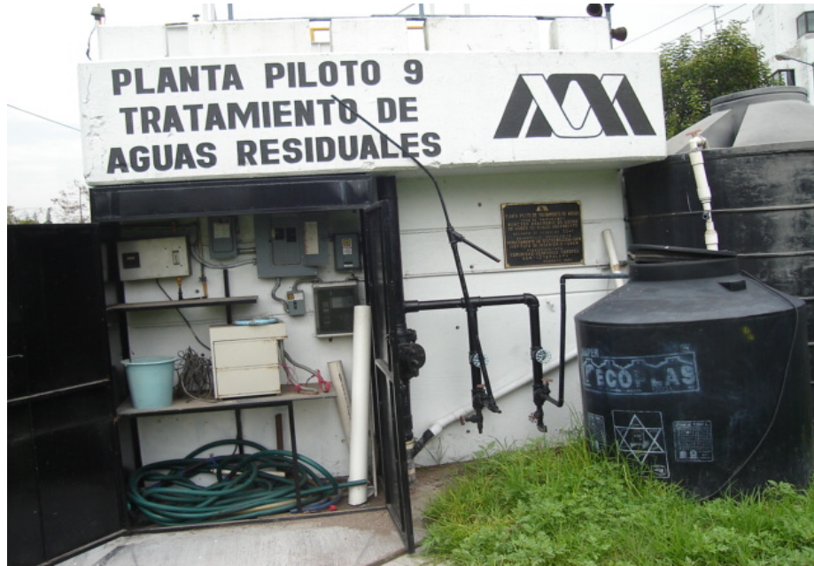
Planta Tratadora de Aguas Residuales UAM Iztapalapa
