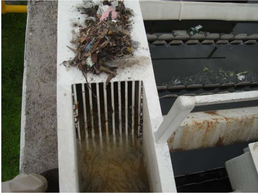
Foto de Rejillas para remover sólidos gruesos
