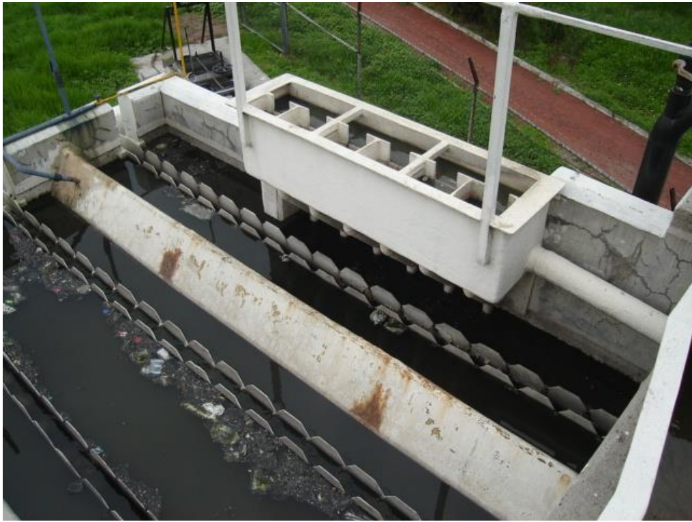
Foto de Cajas de distribución y Canaletas de recolección.
