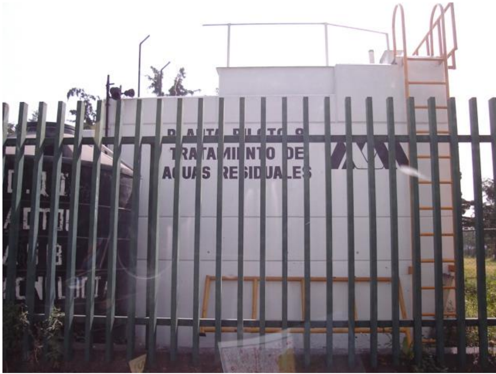
Foto de la Planta de Tratamiento de aguas residuales.
