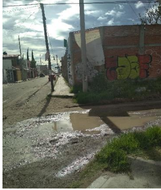
Encharcamiento en calle sin pavimentar en 16 de Septiembre A Poniente y 119 poniente. Recorridos en Granjas Puebla (Oct 2018)
