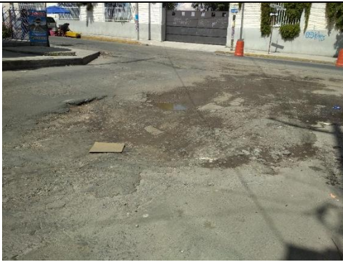
Bache en intersección de la 117 poniente y 3 sur. Recorridos en Granjas Puebla (Oct 2018)
