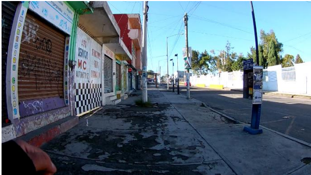
Banqueta deteriorada: 3 sur entre 119 poniente y 121 poniente frente al jardín de niños del Centro Escolar. Recorridos en Granjas Puebla (Dic 2018)
