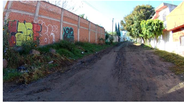
Calle sin pavimentar y sin banquetas: entre 119 poniente y 121 poniente. Recorridos en Granjas Puebla (Dic 2018)
