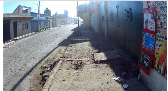
Banqueta deteriorada, basura y grafiti: 119 poniente entre 12 de octubre y 3 sur. Recorridos en Granjas Puebla (Dic 2018)
