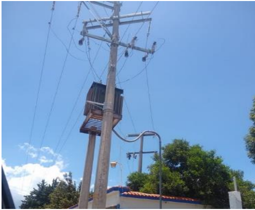
Fotografía 8.- Transformador de luz., Fuente E.G.J.
