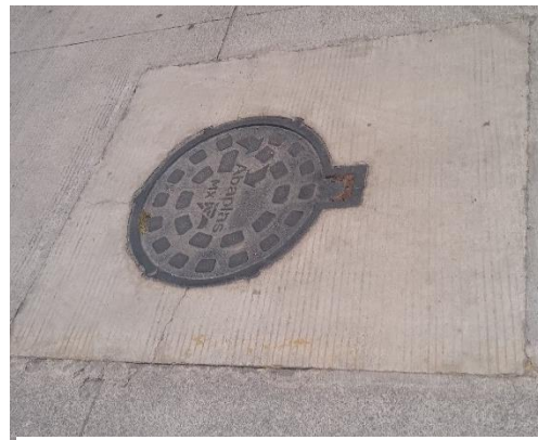
Fotografía 9.- Registro Sanitario (Pozo de Visita)., Fuente E.G.J. 2019
