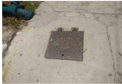
Fotografía 7.- Registro de agua municipal., Fuente E.G.J. 2019
