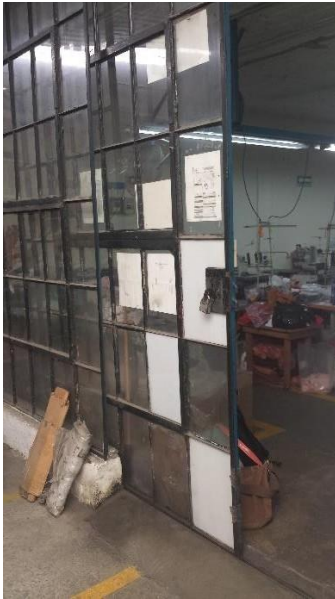
Imagen 4 Puerta carente de mantenimiento.
