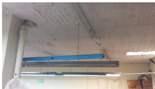
Imagen 11 Estructura de alumbrado general.
