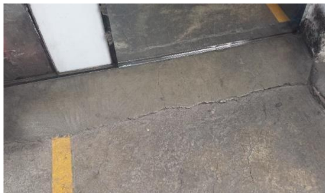
Imagen 15 Rampa situada en la puerta principal del taller.
