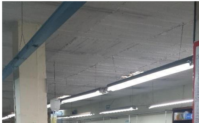
Imagen 12 Fragilidad de la estructura de alumbrado general localizado.
