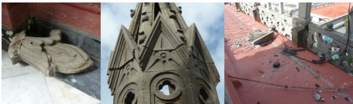
Figura 33 . Afectaciones en la capilla tras sismo de 7.1 grados. (Fotografías ADGO)
