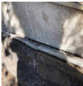
Pieza fracturada en primer nivel
