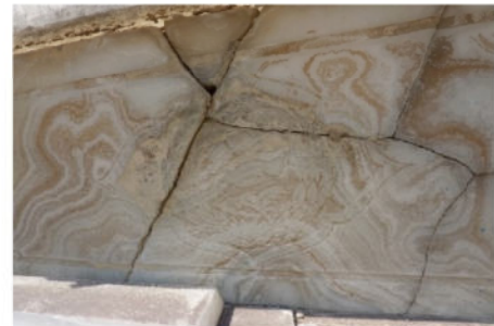
Pieza fracturada en tercer nivel
