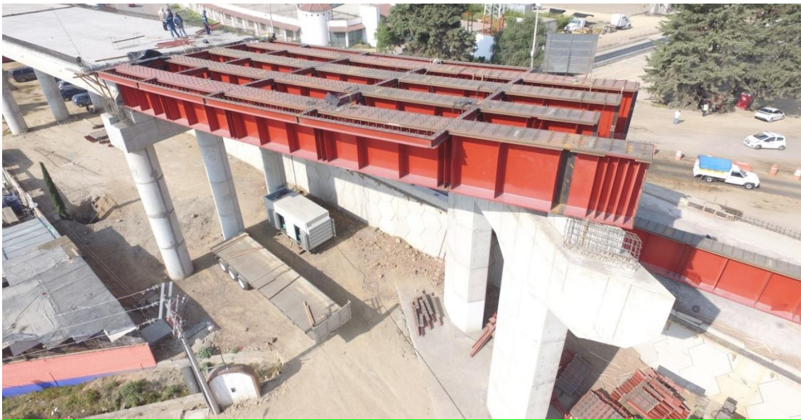
Imagen 14Habilitado de vías metálica en puente “el molinito” en el estado de Tlaxcala
