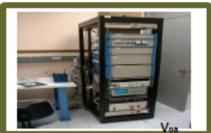
Patrón Nacional de Potencia y Energía Eléctrica
