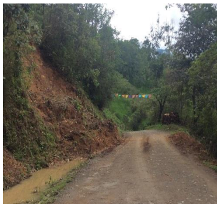
Figura 18. Derrumbe en la población fuertes lluvias (Fuente: Facebook, 01/10/2017 a las 11:12p.m.).
