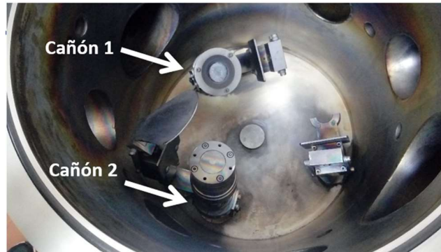
Figura 57: Interior de la cámara del equipo de RF magnetron sputtering.
