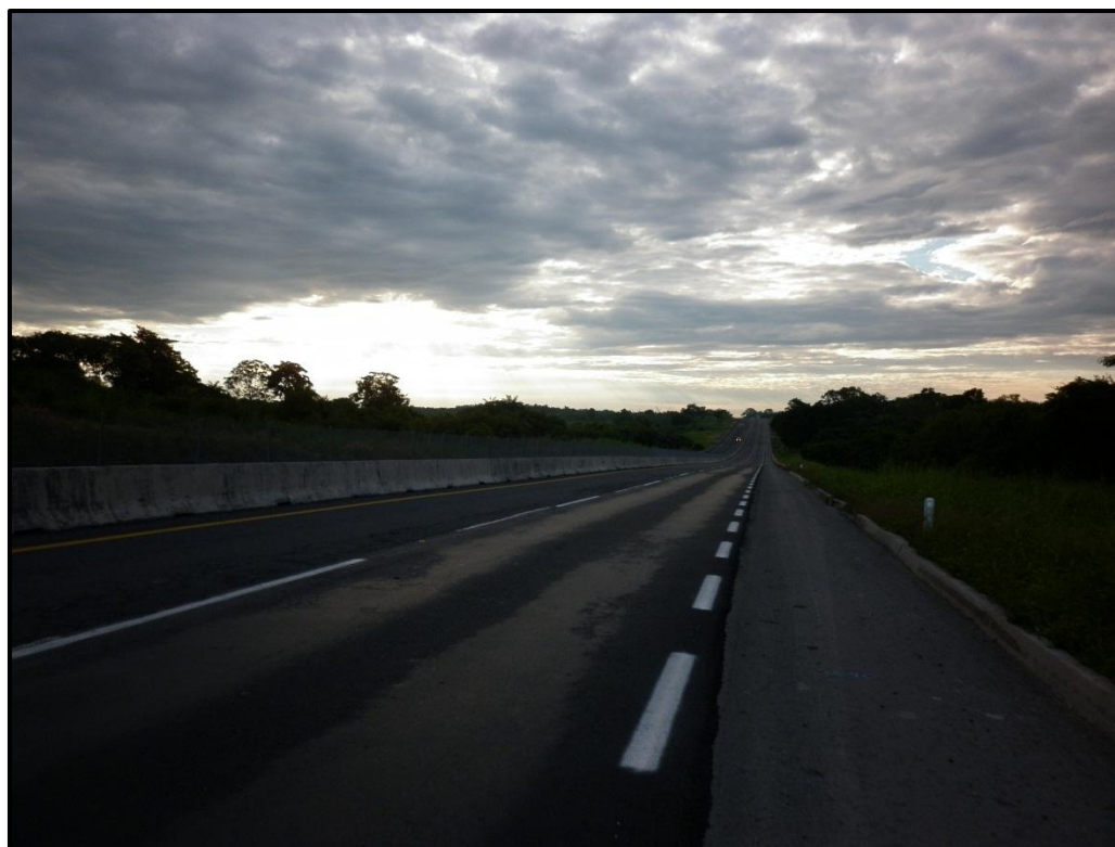
Figura 3.2.8.- Subtramo en mal estado Coatzacoalcos – Tuxtla Gutiérrez
