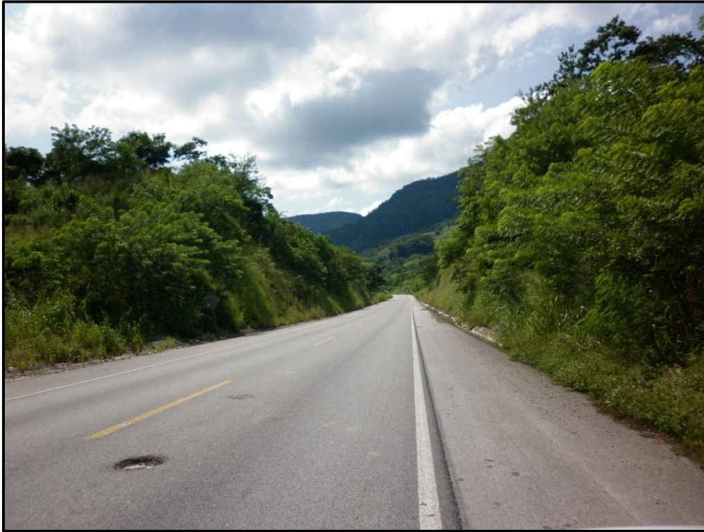
Figura 3.2.9.- Subtramo en mal estado Coatzacoalcos – Tuxtla Gutiérrez
