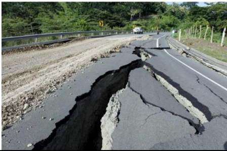
Sismo de 7 grados en Chiapas Fuente: https://noticieros.televisa.com/ultimas-noticias/el-sismo-7-grados-chiapas-dana-escuelas-viviendas-y-carreteras/
