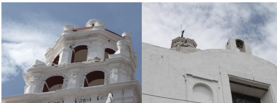
Daños en torre del Templo de La Compañía, en cupulín y muro del Templo de la Soledad Fuente: CA. Estudios Arquitectónicos/Septiembre 2017
