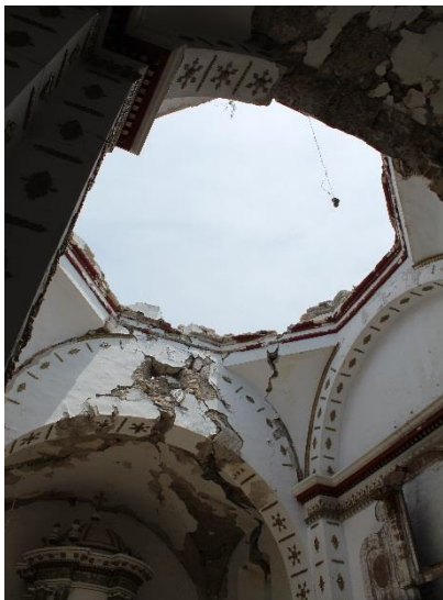
Colapso de cúpulas. Tepexco Fuente: CA. Estudios Arquitectónicos
