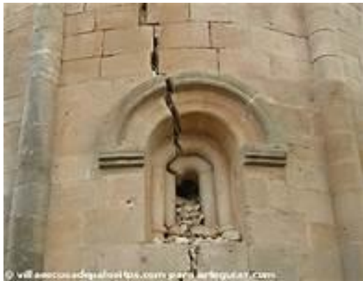
Grietas en muro de piedra
