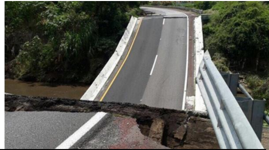
Sismo del 19 de septiembre de 2017 Fuente: https://www.pacozea.com/primeras-afectaciones-los-estados-por-sismo-autopista-del-sol-con-serio-dano
