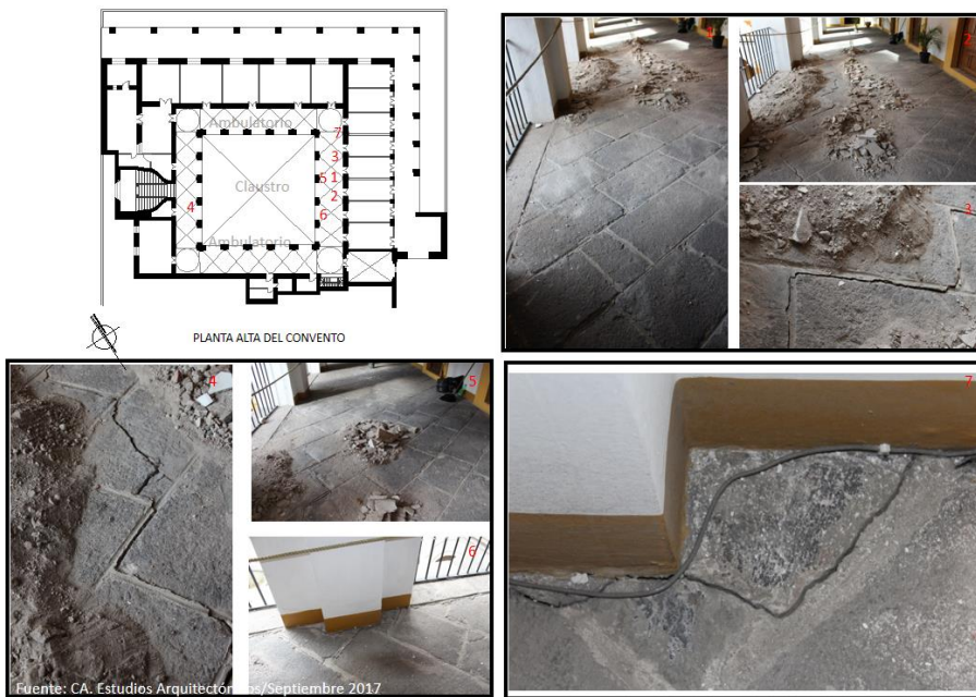
Levantamiento fotográfico de fisuras y grietas en pisos del claustro alto. Editado: Ma. José Mendoza Vázquez 21/septiembre/2017
