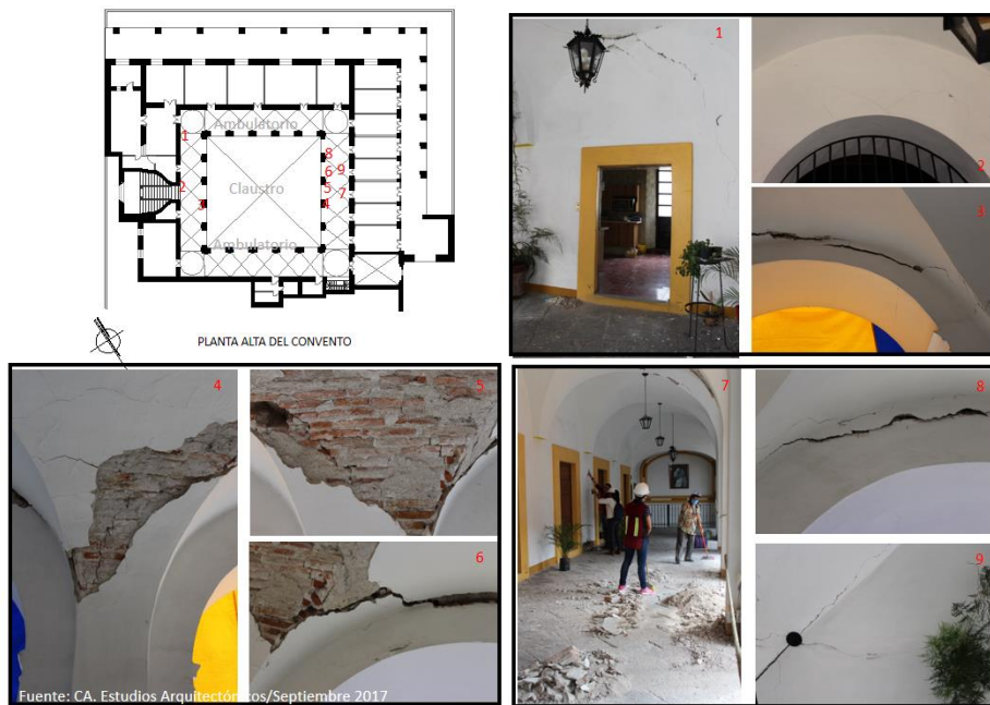
Levantamiento fotográfico de fisuras, grietas y colapso de bóvedas en claustro alto. Editada: Ma. José Mendoza Vázquez 21/septiembre/2017
