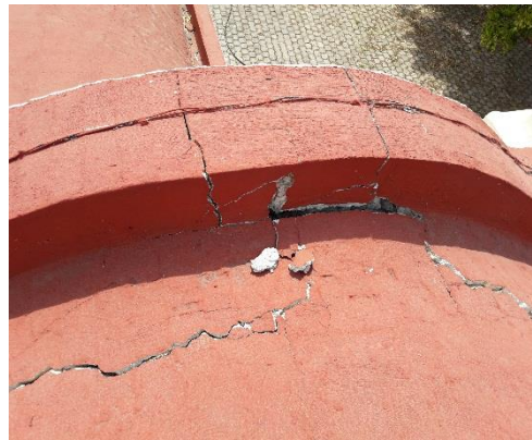
Grietas en bóveda. Ayotliha Fuente: CA Estudios Arquitectónicos
