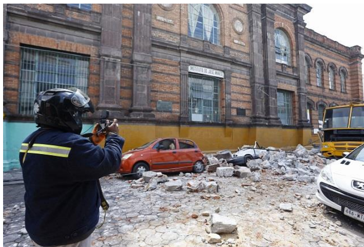
Municipios Puebla. 2017. Demolerán 36 escuelas con daños graves por sismo en Puebla. Fotografía. Recuperada de: http://municipiospuebla.mx/nota/2017-09-22/puebla/demoler%C3%A1n-36-escuelas-con-da%C3%B1os-graves-por-sismo-en-puebla .
