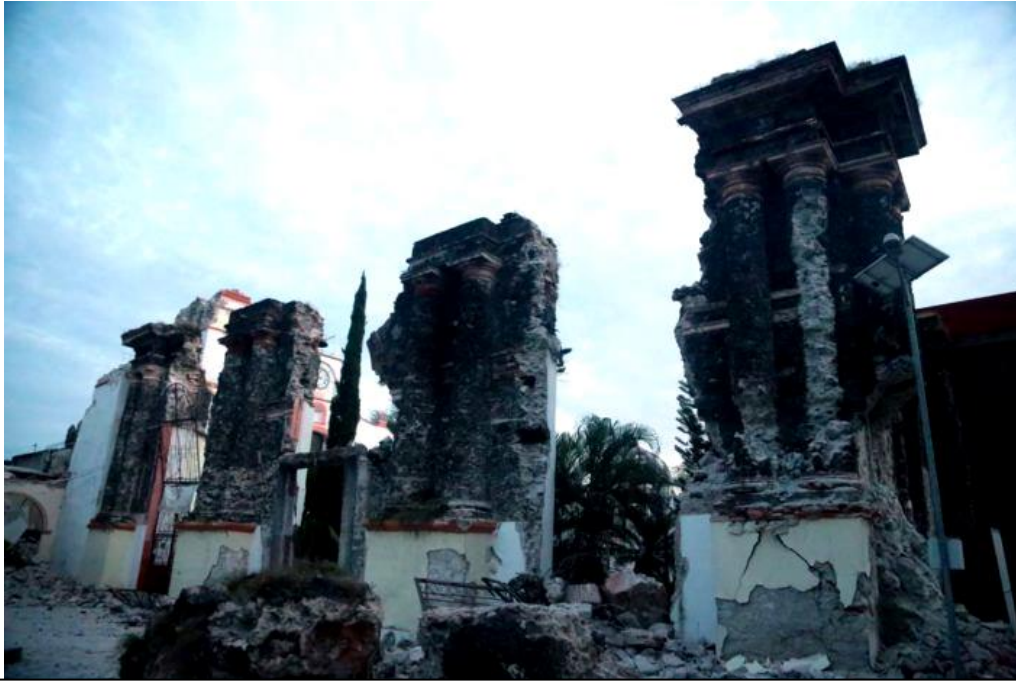
Pérez, Margarito; 2017. Los daños por el sismo en Jojutla, Morelos; Fotografía. Recuperada de: https://www.proceso.com.mx/504294/morelos-contabiliza-73-muertos-dano-en-200-inmuebles-patrimonio-historico-cultural .
