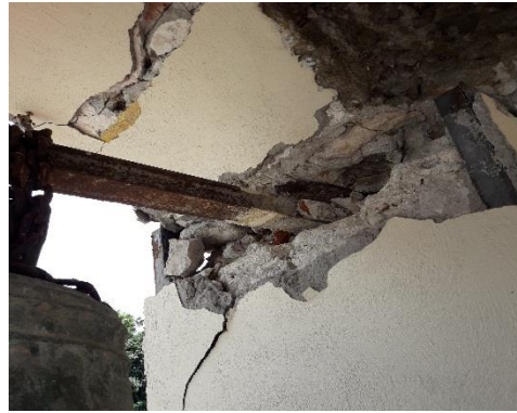
Fractura en Muro. Ayotliha Fuente: CA. Estudios Arquitectónicos
