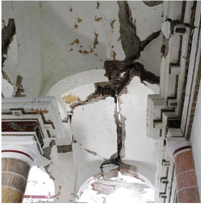
Fractura en bóveda. Tepexco Fuente: CA Estudios Arquitectónicos
