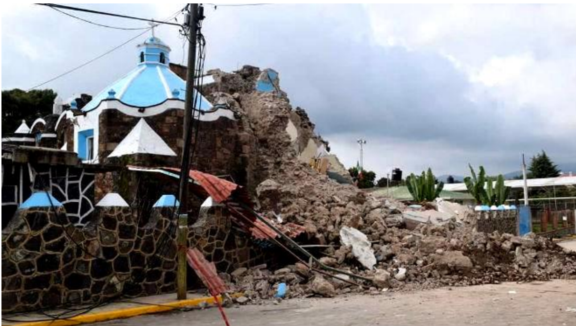
Miranda, Antonio. 2017; Ocuilan Sismo ; Ocuilan Estado de México. Fotografía. Recuperada de: http://www.unionedomex.mx/articulo/2017/09/20/ciudadanos/ocuilan-estado-de-mexico-asi-los-danos-tras-sismo .
