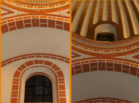
Grietas en arco de ventana y arco toral
