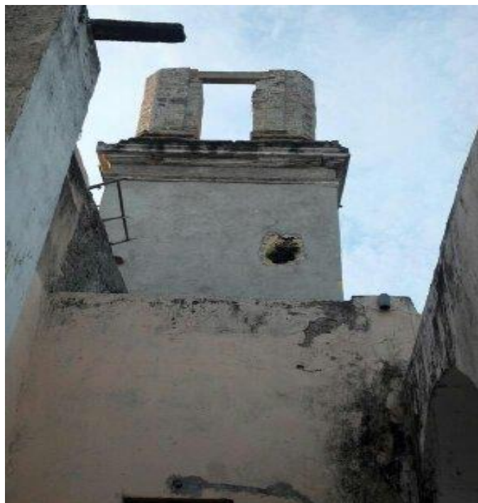
Ilustración 35 Torre Norte del Templo perforación por cañonazo recibido durante el sitio de 1862; Fuente de la fotografía: Propia del Autor.
