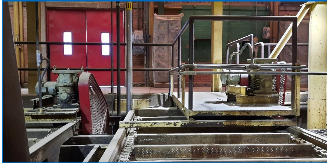
Ilustración 30 Vista a nivel de piso de la nave Molino de Copra. Actualmente en desuso, provocando el avance de los deterioros en los metales y concretos. Fuente: Tomada el 2 de junio de 2021 por PAGA
