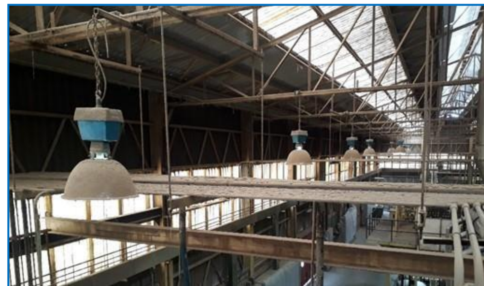
Ilustración 2 Interior de la nave Molino de Copra. Se observa la falta de mantenimiento en las estructuras e instalaciones. Fuente: Tomada el 15 de octubre de 2020 por PAGA
