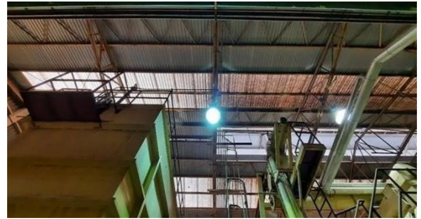
Ilustración 53 Interior de la nave Molino de Copra. la fotografía muestra las luminarias. Fuente: PAGA
