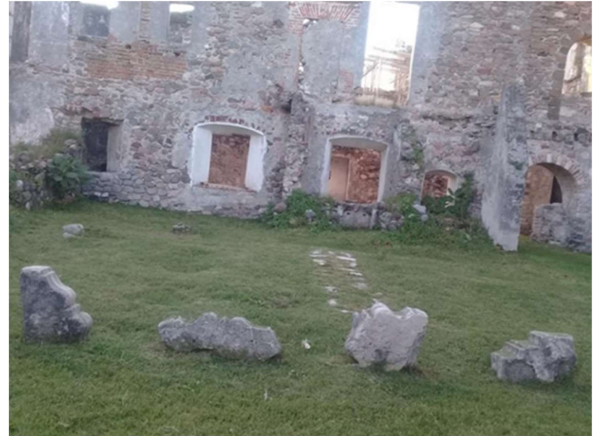
Imagen 67: Pérdida de material en muro del exconvento de San Francisco Totimehuacán. 2023 imagen: Jatsiri Pérez
