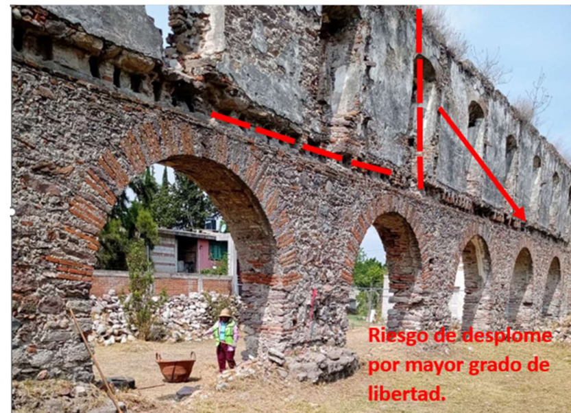
Imagen 61: Deterioro en muro sur del exconvento de San Francisco Totimehuacán. 2023 imagen: Jatsiri Pérez
