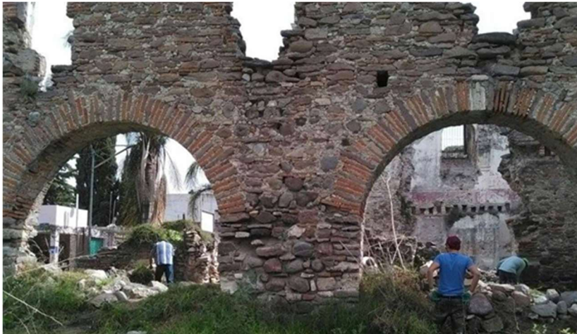
Imagen 66: Daño en sillares de arcos de medio punto en el exconvento de San Francisco Totimehuacán. 2023 imagen: Jatsiri Pérez
