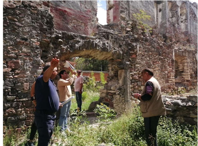
Imagen 63: Pérdida de material en muro sur del exconvento de San Francisco Totimehuacán. 2023 imagen: Asociación Tepalcayotl.
