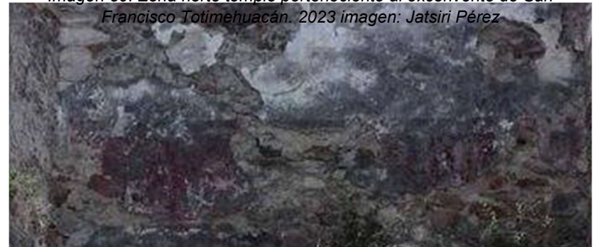
Imagen 60: Deterioro en muro del exconvento de San Francisco Totimehuacán. 2023 imagen: Jatsiri Pérez
