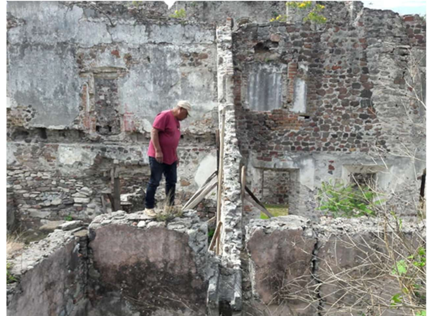
Imagen 65: Falta de amarres en el muro norte del exconvento de San Francisco Totimehuacán. 2023 imagen: Asociación Tepalcayotl.
