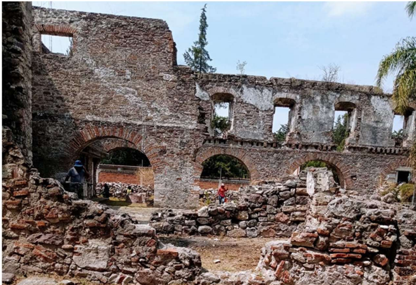
Imagen 62: Erosión de materiales en muro sur del exconvento de San Francisco Totimehuacán. 2023 imagen: Jatsiri Pérez.
