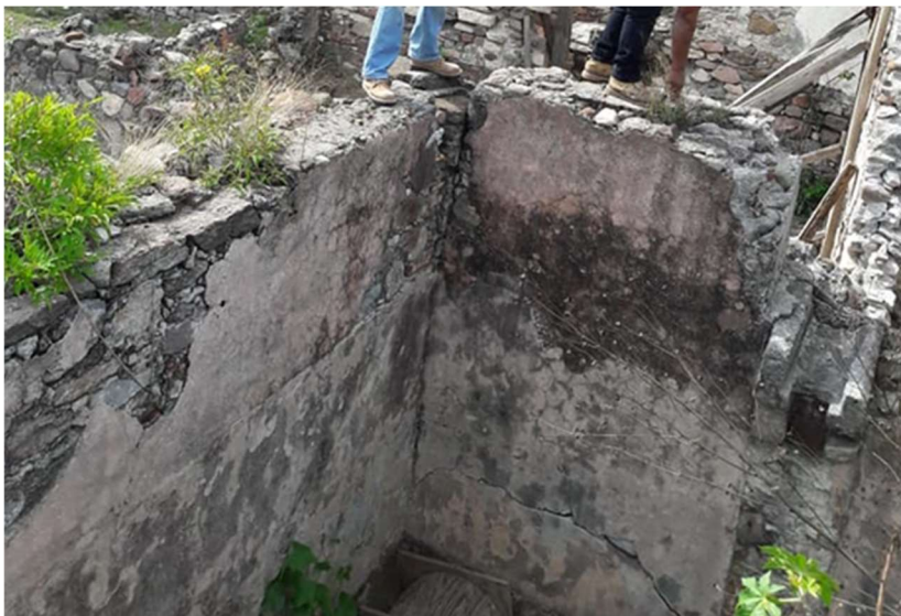
Imagen 64: Falta de amarres en el muro norte del exconvento de San Francisco Totimehuacán. 2023 imagen: Asociación Tepalcayotl.
