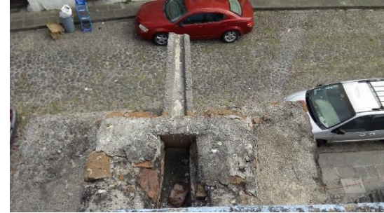
Fotografía 26 Bajada pluvial en mal estado; Templo de Santa Inés del Barrio de Xanenetla. Gabriela Toledo G. (Sep-2017)
