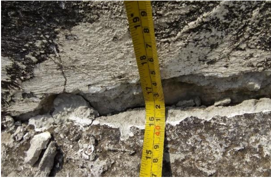
Fotografía 24 Azotea; juntas abiertas; Templo de Santa Inés del Barrio de Xanenetla. Gabriela Toledo G. (Sep-2017)
