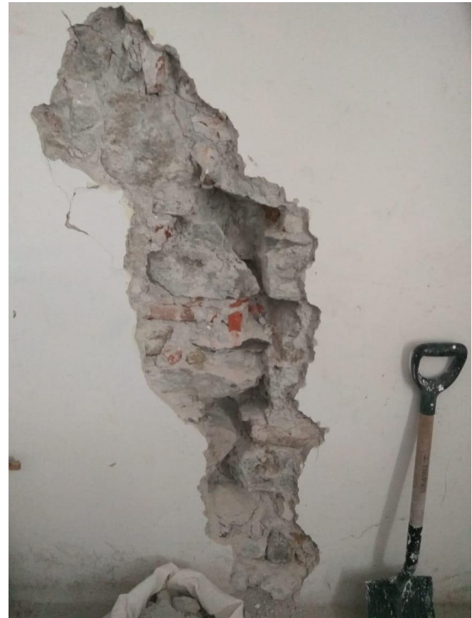
Fotografía 21 Cala en grieta de muro en zona de sotocoro. Templo de Santa Inés del Barrio de Xanenetla. Gabriela Toledo G. (2018)
