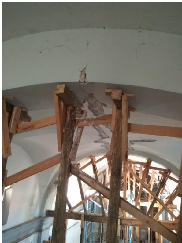
Fotografía 22 Grieta de bóveda de nave principal. Templo de Santa Inés del Barrio de Xanenetla. Gabriela Toledo G. (2018)
