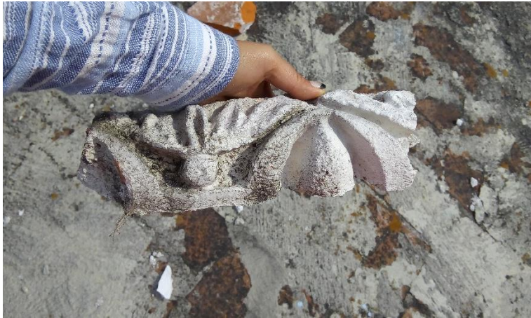
Fotografía 27 Desprendimiento de ornamentación, Templo de Santa Inés del Barrio de Xanenetla. Gabriela Toledo G. (Sep-2017)
