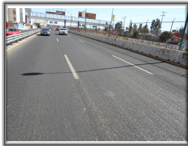
La fotografía muestra una grieta longitudinal en km. 21+100 cuerpo "B"
