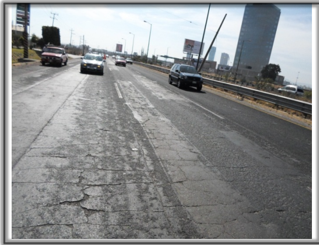
La fotografía muestra agrietamiento de piel de cocodrilo en km. 15+600 cuerpo "B".
