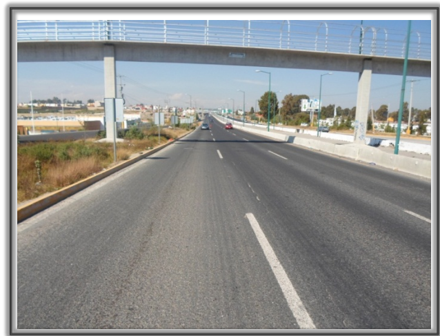
La fotografía nos muestra la grieta longitudinal localizada en km. 22+500 cuerpo "A"
