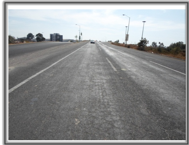
La imagen fotográfica muestra grietas transversales y desprendimiento en km. 7+600 cuerpo "B"
