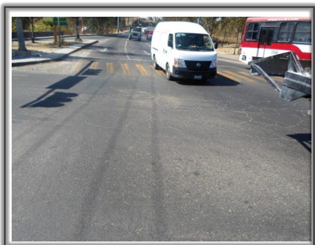
Se observa grietas de piel de cocodrilo en km. 25+600 cuerpo "A".
