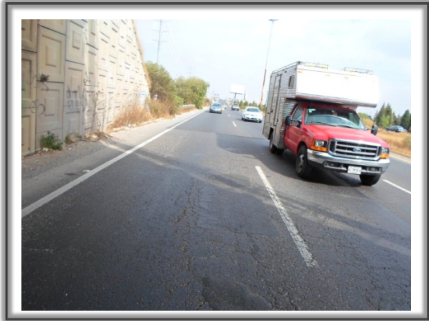
En esta toma fotografía se observa al agrietamiento de tipo piel de cocodrilo en km. 0+700 cuerpo "A"
