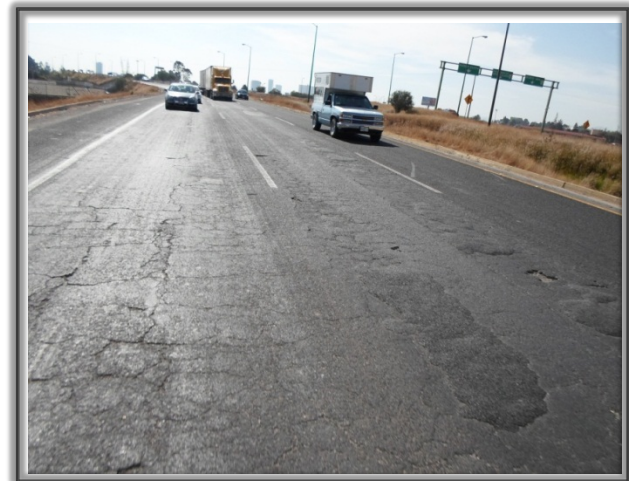
La fotografía muestra grietas longitudinales y transversales en km. 13+400 cuerpo "B"
