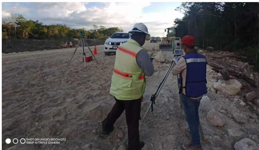
Imagen 43. Conciliación de colocación de poligonal con empresa supervisora en tramo 2 del tren maya, Campeche. Fuente: Propia.
