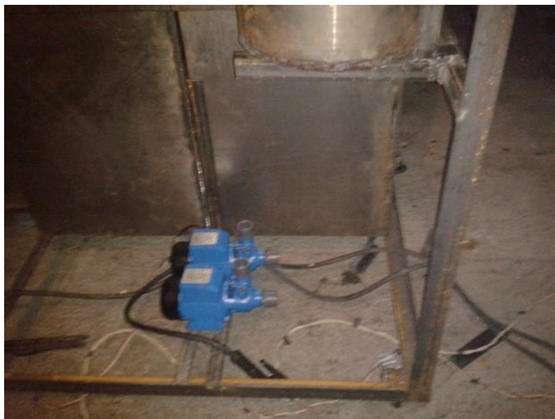
Figura 22: Bombas eléctricas. Fuente: Valentín Gálvez
