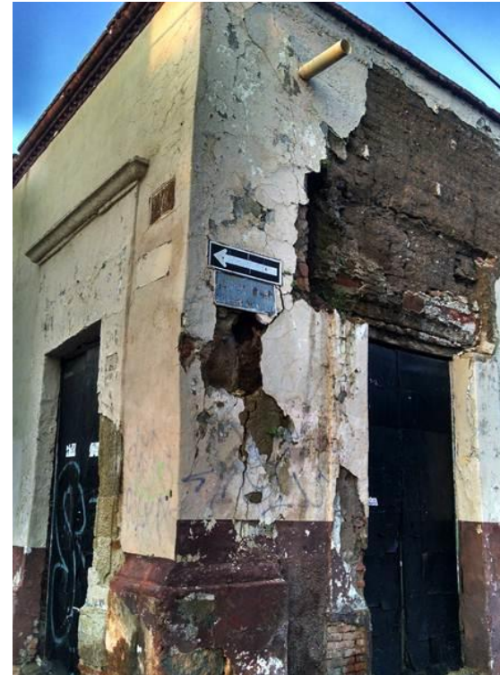
Fotografía 25, tomada de la fachada de una vivienda en pésimas condiciones
