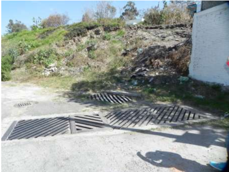
Imagen 30. Ramírez Flores, J. (2015). Obstrucción de corriente de agua superficial y falta de mantenimiento a drenajes. [Fotografía]. Puebla. Colonia la Hacienda.
