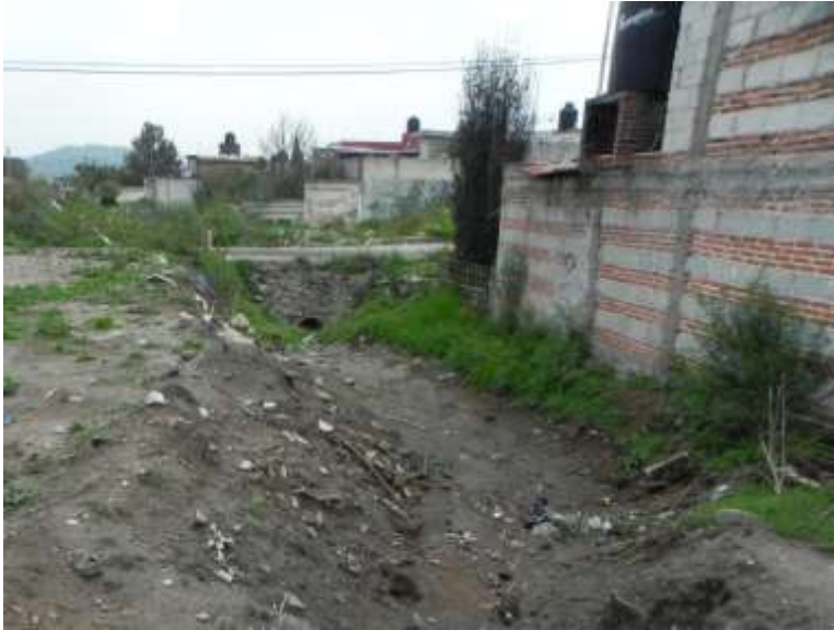
Imagen 58. Ramírez Flores, J. (2015). Arroyo “Clavijero” y el estrangulamiento de su cauce por la instalación del puente vial; trabajos de desazolve, material suelto y sembrados de vivienda sin área de amortiguamiento. [Fotografía]. Puebla: Colonia Francisco Javier Clavijero.
