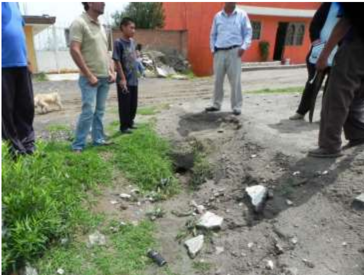
Imagen 59. Ramírez Flores, J. (2015). Al fondo dos viviendas obstruyen el cauce del Arroyo, en segundo plano el bordo generado por el relleno utilizado para la creación de la vialidad y en primer plano el tubo de drenaje obstruido e insuficiente para dar salida al agua que se anega aguas arriba. [Fotografía]. Puebla: Colonia Clavijero.
