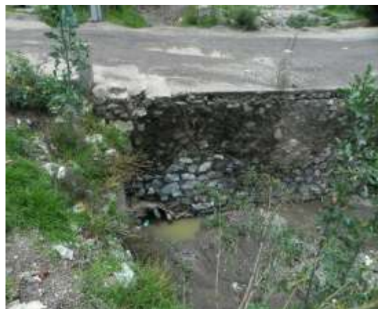
Imagen 53. Ramírez Flores, J. (2014). Infraestructura de drenaje fuera de proporción. [Fotografía]. Puebla: Colonia Clavijero.
