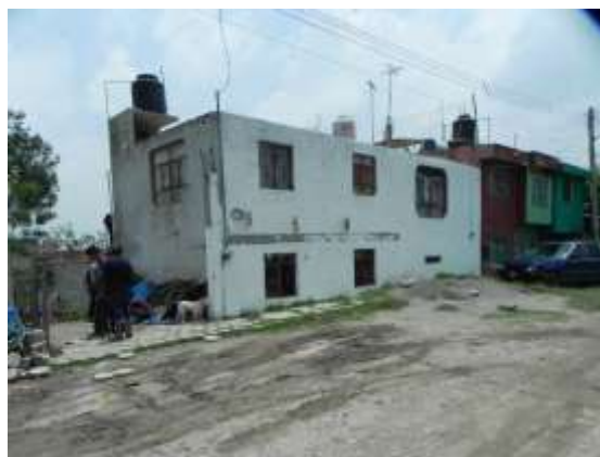
Imagen 56. Ramírez Flores, J. (2015). Frente de la vivienda: el nivel de la calle ha aumentado con respecto al de la construcción a consecuencia de la erosión del suelo. [Fotografía]. Puebla: Colonia Clavijero.
