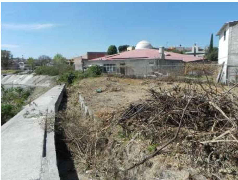
Imagen 29. Ramírez Flores, J. (2015). Bienes inmuebles expuestos al cauce principal y falta de mantenimiento en obras hidráulicas . [Fotografía]. Puebla. Colonia la Hacienda.
