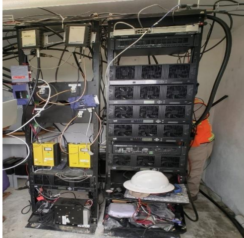
Figura 12 Infraestructura de repetidor para red eléctrica [autoría propia]
