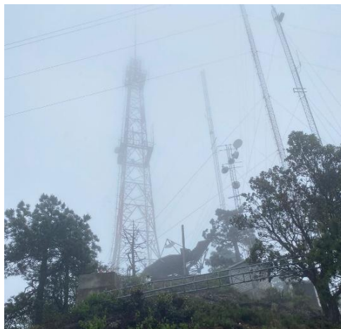
Figura 13 Torres repetidoras de telecomunicaciones utilizadas para ampliar la cobertura de la red RF. [autoría propia]
