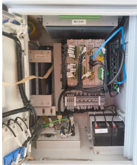
Figura 15 Gabinete de control marca Wasion [autoría propia]
