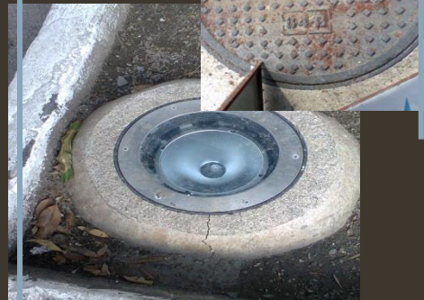
IMAGEN 23 ALUMBRADO, arriba POSTES SIN CABLES, esquina de la 14 oriente y 2 norte, al centro REGISTRO DE CFE, abajo LUMINARIA DE JARDÍN, PARQUE DE SAN JOSÉ, ILUMINACIÓN DECORATIVA, tomada por RKHR, junio 2013.
