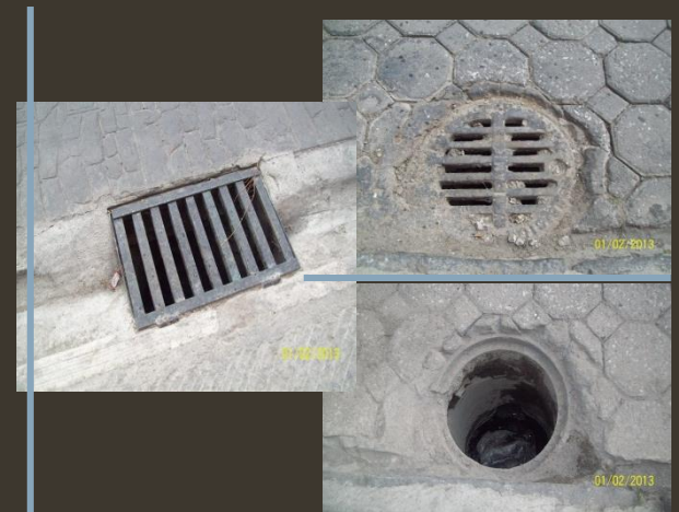
IMAGEN 23 ALCANTARILLAS, arriba alcantarilla tradicional, con residuos de material de obra. Al centro nuevas alcantarillas sobre la 2 norte. Abajo, alcantarilla sin tapa, y con basura, tomadas por RKHR, junio 2013.
