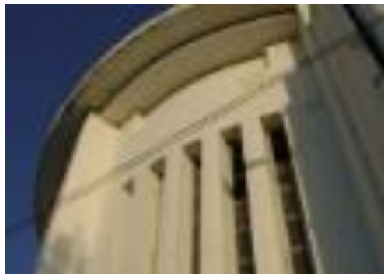
Fig 1.4.e Escuela Ignacio Zaragoza con dispositivos de ventilación.
