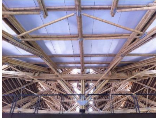
Figura 12 Deformación elevada de viga
