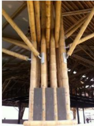
Figura 14 Columna formada por elementos aislados
