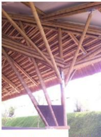
Figura 13 Unión induciendo comportamiento de columna corta
