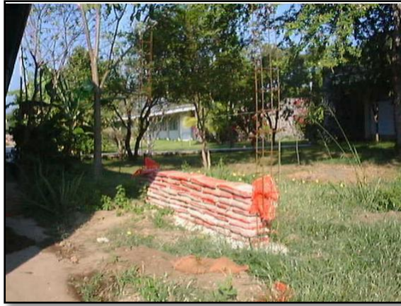
Fotografía EDLFL 2001, El muro se construye en etapas hasta su terminación. Se construye una parte y tiempo después se construye otra y así sucesivamente hasta que se termina.
