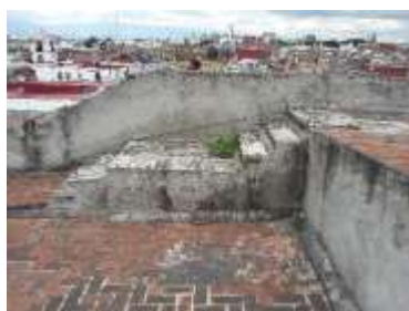
Ilustración 128. Desprendimiento de aplanados Foto tomada por Arq. Jesús Saucedo León 2016
