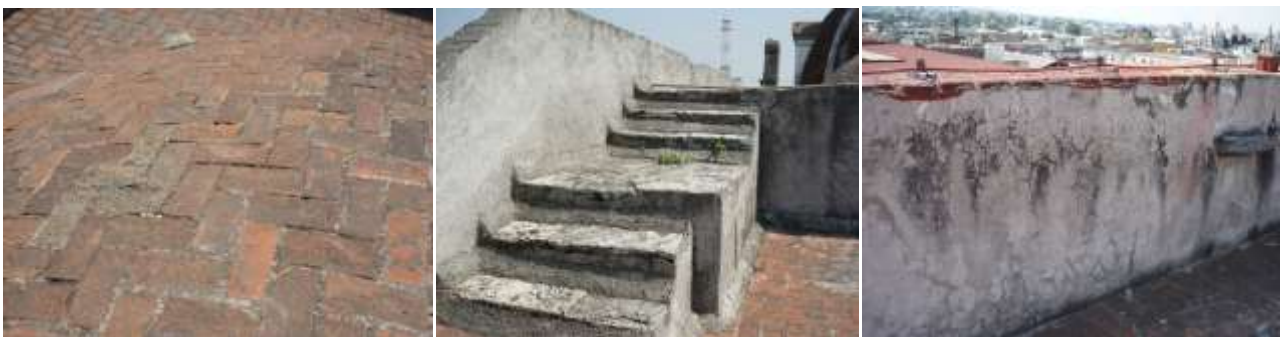
Ilustración 6, 7 y 8 Disgregación de materiales, presencia de humedades en pretiles y en cubierta, agrietamiento en aplanados y presencia de parásitos vegetales en cubierta. Fotos tomadas por Arq. Jesús Saucedo León 2016
