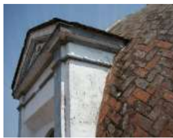
Ilustración 133. Acumulación de humedad y agrietamiento en aplanados de lucarnas. Foto tomada por Arq. Jesús Saucedo León 2016
