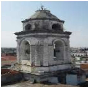
Ilustración 137. Desprendimiento de aplanados en campanario. Foto tomada por Arq. Jesús Saucedo León 2016
