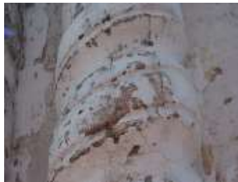
Ilustración 138. Agrietamiento de aplanados en columnas salomónicas. Foto tomada por Arq. Jesús Saucedo León 2016
