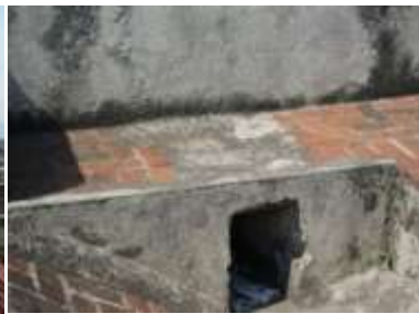
Ilustración 124. Azolve en gárgolas y presencia de fauna. Foto tomada por Arq. Jesús Saucedo León 2016
