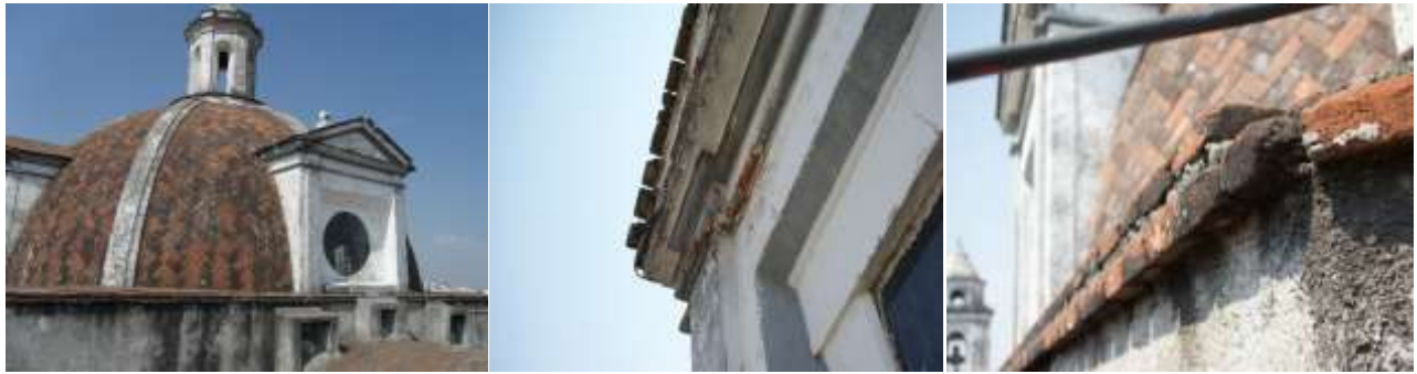
Ilustración 3, 4 Y 5 Presencia de humedades, disgregación de materiales, perdida de elementos ornamentales, agrietamiento en aplanados y presencia de parásitos vegetales en cúpula y base. Fotos tomadas por Arq. Jesús Saucedo León 2016
