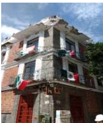
Ilustración 183. Colapso de balcones y volado en Hotel que se ubica en la 3 Oriente. Obtenida el: 20 de septiembre de 2017 por Arq. Jesús Saucedo León
