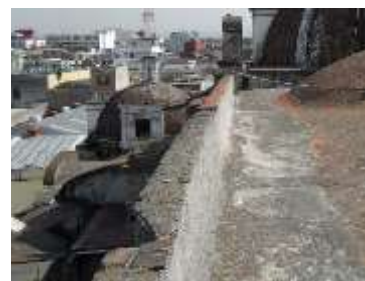
Ilustración 129. Disgregación de tabiques y pérdida de los mismos. Foto tomada por Arq. Jesús Saucedo León 2016
