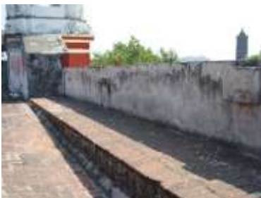
Ilustración 127. Pérdida de la capa de pintura vinílica. Foto tomada por Arq. Jesús Saucedo León 2016
