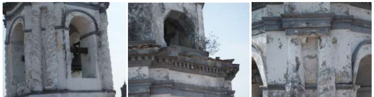
Ilustración 9,10 y 11 Agrietamiento en aplanados, presencia de humedades, perdida de elementos ornamentales, presencia de parásitos vegetales y disgregación de cornisas en campanario. Fotos tomadas por Arq. Jesús Saucedo León 2016
