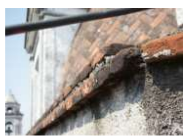
Ilustración 134. Perdida de consistencia en juntas, piezas faltantes y humedades directas en base de cúpula. Foto tomada por Arq. Jesús Saucedo León 2016
