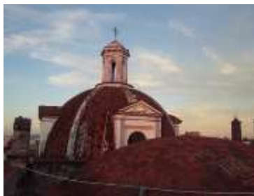
Ilustración 132. Humedades directas y desprendimiento de aplanados en linterna. Foto tomada por Arq. Jesús Saucedo León 2016
