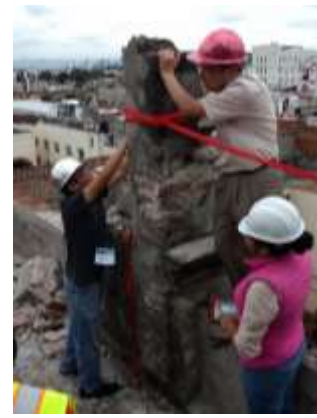
Ilustración 185. Pérdida total de espadaña del Templo de Santa Inés. Obtenida el: 20 de septiembre de 2017 por Arq. Jesús Saucedo León
