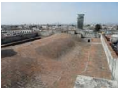
Ilustración 122. Presencia de humedad directa en petatillos en bóveda. Foto tomada por Arq. Jesús Saucedo León 2016
