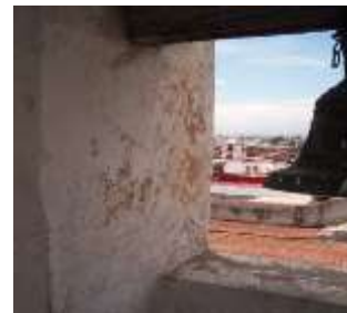
Ilustración 139. Desprendimiento de aplanados en campanario. Foto tomada por Arq. Jesús Saucedo León 2016
