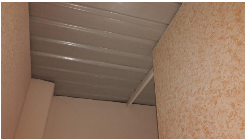
Figura 16. Detalle de lámina de fibra de vidrio en escaleras. Foto de Mtro. Juan Manuel Bautista
