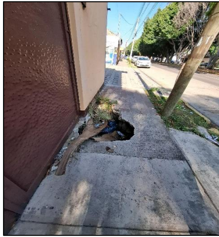
Fotografía 24 “Deterioro de banquetas”. Foto propia. Hernández A y Tinajero E. (2024)
