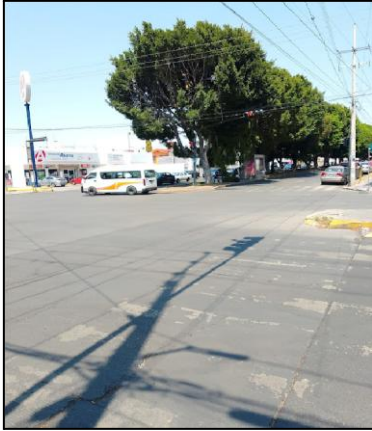
Fotografía 42. “Estado de pavimentos” . Foto propia. Hernández A y Tinajero E. (2025)
