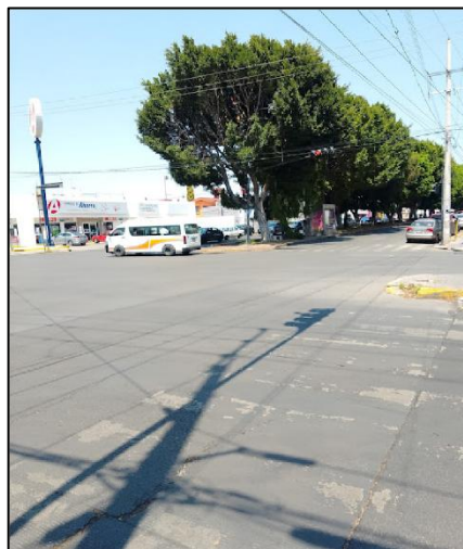
Fotografía 40. “Estado de pavimentos”. Foto propia. Hernández A y Tinajero E. (2025).
