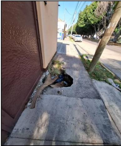
Fotografía 26 “ Deterioro de banquetas ”. Foto propia. Hernández A y Tinajero E. (2024)
