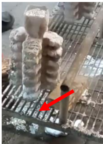
Figura 41. Escape de material debido a grietas en concha cerámica
