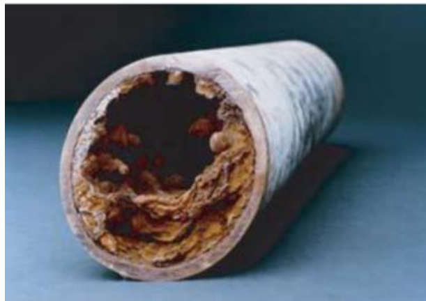
Figura 5. Tubería dañada por la corrosión.
