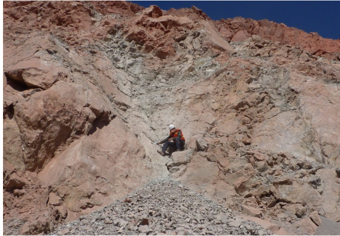
Figura 2.6. Ejemplo de rotura en cuña en el talud en estudio
