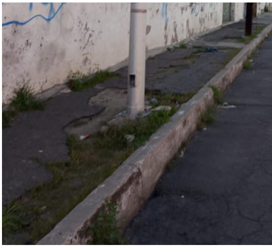
Imagen 11. Condición actual del área peatonal Fuente: Recorridos de campo, Cruz, López, (2024).
