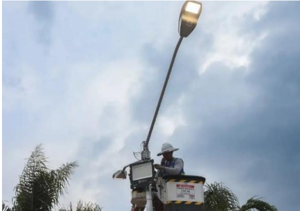
Imagen 54. Luminarias que se implementara en barrio de Santa Anita Fuente: Imagen referenciada de Google (2025).
