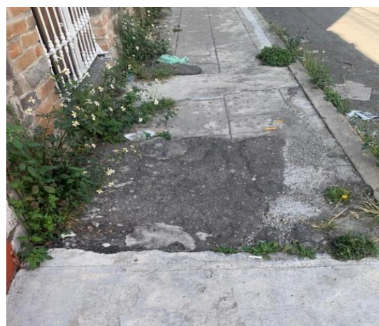
Imagen 14. Condición actual del área peatonal Fuente: Recorridos de campo, Cruz, López, 2024.
