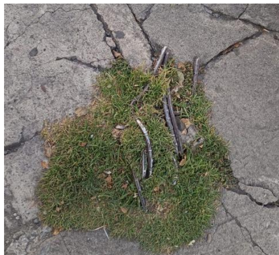
Imagen 12. Condición actual del área peatonal Fuente: Recorridos de campo, Cruz, López, (2024).
