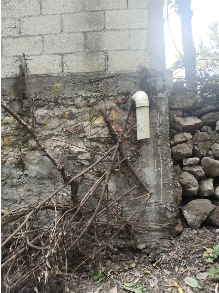
Imagen 6. Desagüe de aguas negras. Baño público a la orilla del cauce principal.
