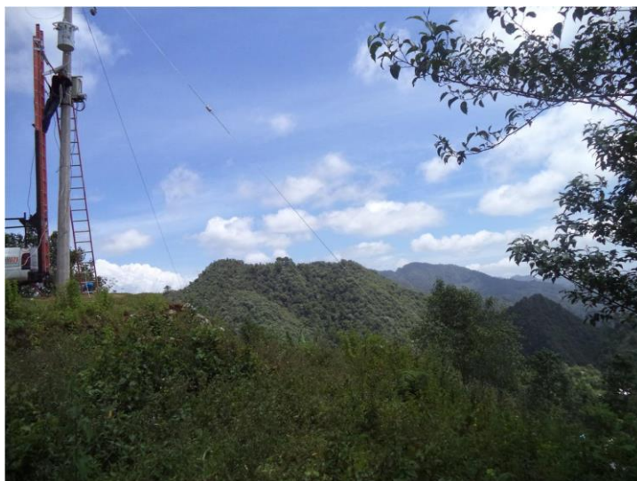
Imagen 68. Medidor colector, kit de comunicación, antena yagui y antena satelital instaladas en una de las partes más altas de la población de Chichiquila.
