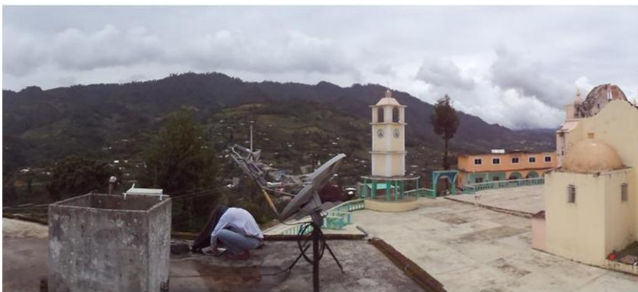
Imagen 61. otra vista del lugar donde se encuentra instalado el medidor colector, así como la antena satelital en una de las partes más altas de la población de Huaxcaleca, para poder recibir la información de los medidores esclavos que se encuentran instalados en las poblaciones aledañas y así enviar dicha información al sistema más.
