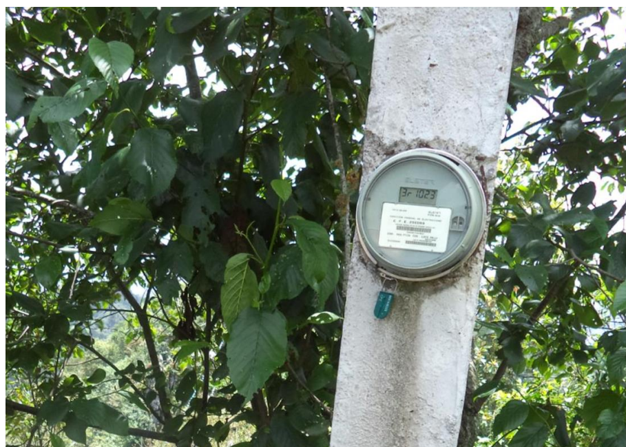
Imagen 63. Ejemplo de medidor mostrando en su display que este medidor se encuentra en el tercer salto de repetición de información.
