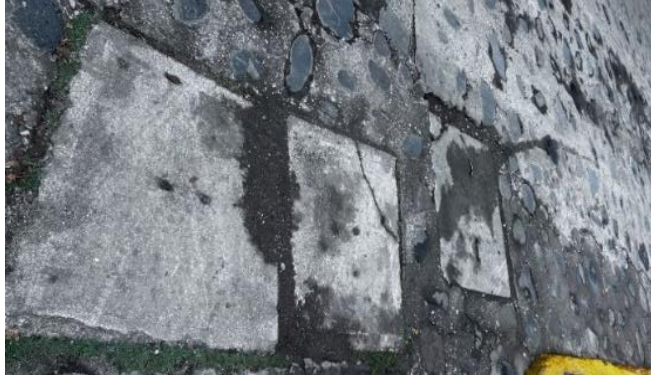
Ilustración 69 Registro sanitario sobre avenida Galeana Fuente: Alejandro Flores (2025).
