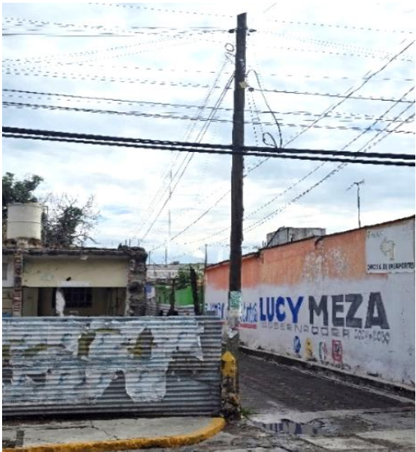
Ilustración 70 Poste de energía eléctrica. Fuente: Alejandro Flores (2025).
