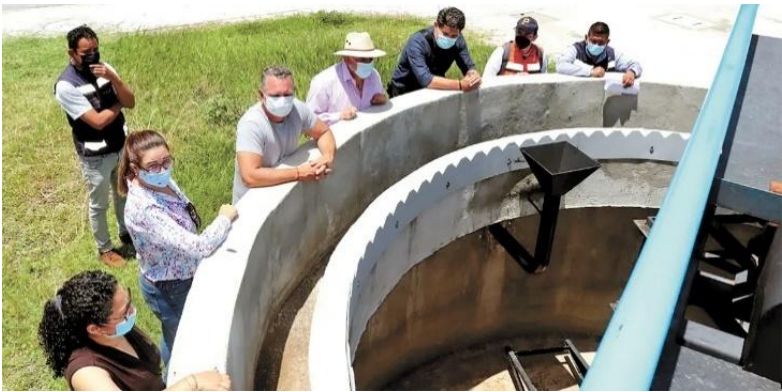
Ilustración 55 Planta de tratamiento de aguas residuales. Jantetelco, Mor. Fuente: Boletín Morelos. (2021)
