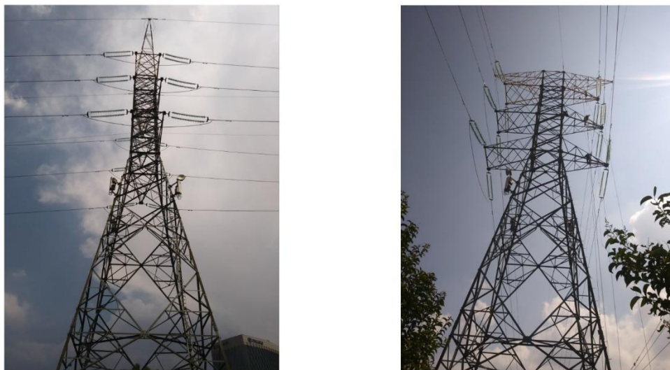
Figura 2. 18 Torre Autosoportada de doble circuito de 230 kV para la L.T. TYA-93E70-SNG
