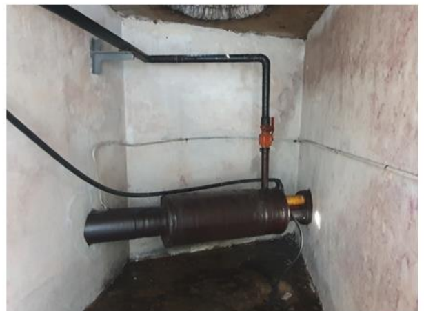
d) Trifurcador, toma de presurización y cable de protección catódica.
