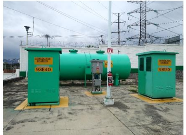
b) Consolas de bombeo y contenedor presurizado
